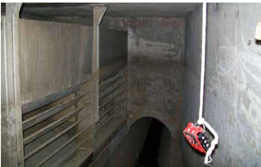
Der Kanalstauraum liegt links hinter der Lamellentauchwand. Das Wasser fließt von links durch die Tauchwand in den Kanal, der in den Bermersheimer Graben entwässert. Rechts im Bild (am Seil hängend) ist ein Gaswarngerät zu sehen.
